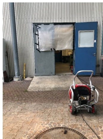
Abb. 39: 230V-Lüfter im Abstand von 2m vor halb verschlossener Zuluftöffnung
