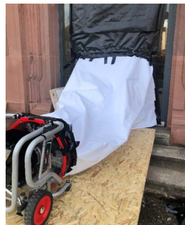
Abb. 53: Lüfter mit Lutte. Die Lutte hat einen runden Einlass mit ca. 500mm Durchmesser und einen quadratischen Auslass mit 1m x 1m.
