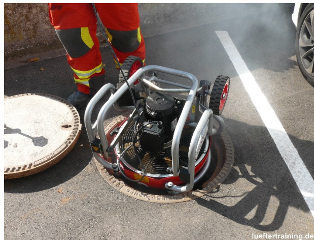
Abb. 4: Belüftung von Kanalanlagen (www.lueftertraining.de 2020)
