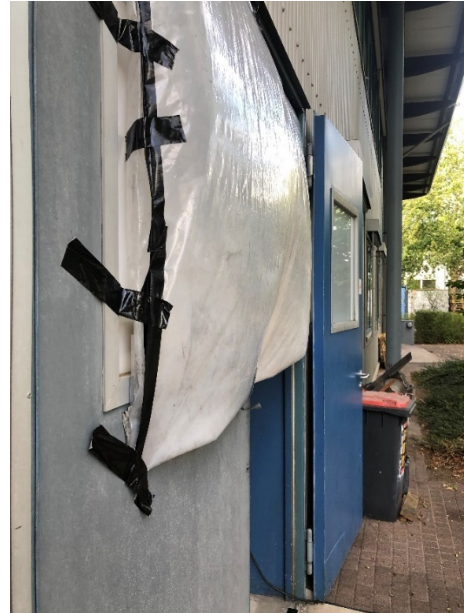
Abb. 32: Nach außen gewölbte Türabdeckung Werkstatt
