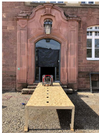
Abb. 51: Lüfter vor teilweise abgedeckter Türöffnung (H=105cm x B=97cm)
