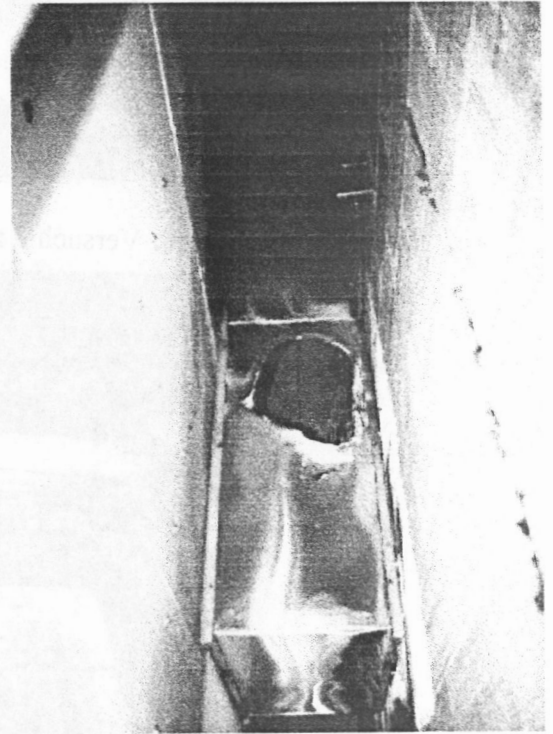
Foto 4: Unterer Fensterkasten (Außenbereich) nach Versuch 1 mit zerstörter vertikaler Aluminiumabschottung.
