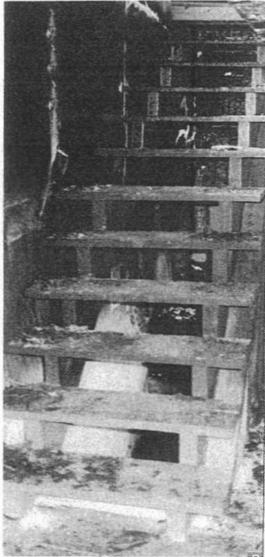
Bild 4.1: Brandbeanspruchung der Holztreppe nimmt von unten nach oben zu.
