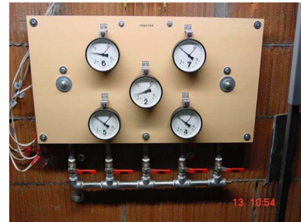
Anzeige-Tableau für Indikatorsprinkler (Manometer) und Rauchmelder (Leuchtdioden über den Manometern)
