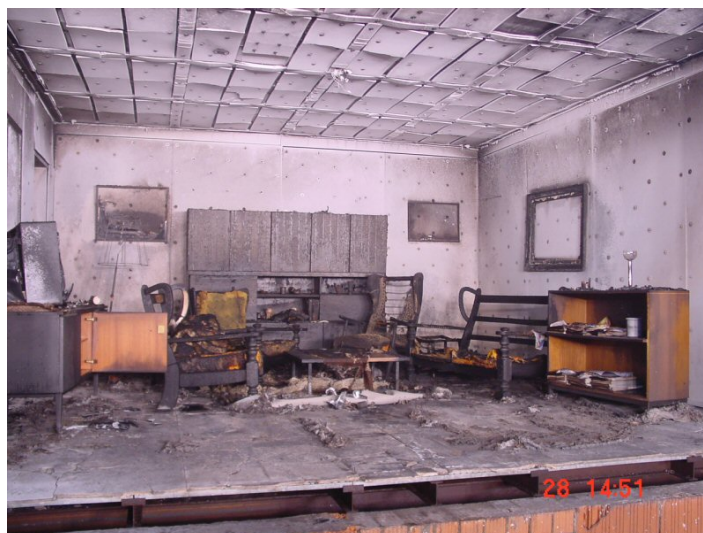
Bild 5-6 Brandraum nach dem Löschen [FFB]
