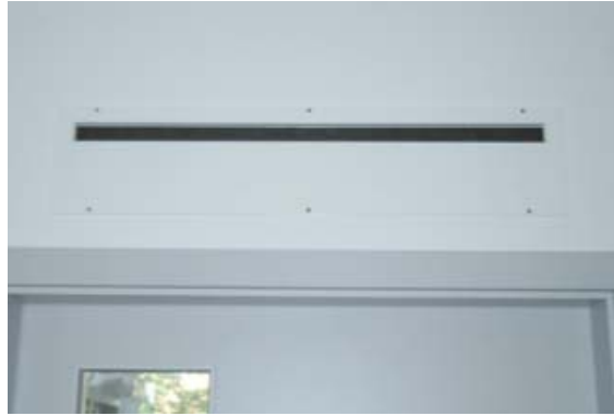
Bild 4-3 Überströmöffnung oberhalb einer Tür [www.zukunft-haus.info]
