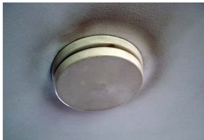
Bild 4-81 Verschmutzter Luftauslass an der Zimmerdecke
