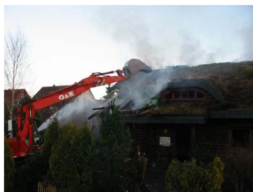
Bild 2-4 Bagger versucht die Dachlast des begrüntes Daches zu verringern [www.feuerwehr-extertal.de]
