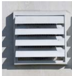
Bild 7-7 Auslass einer Lüftungsanlage [ www.architec24.de ]
