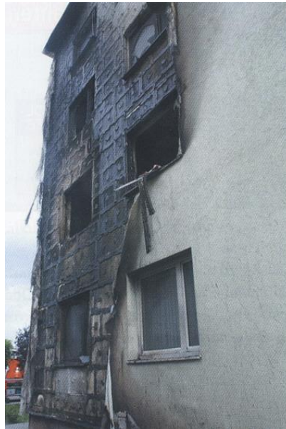
Abbildung 2-1: Zerstörte Hausfassade, welche mit einem brennbaren WDVS wärmedämmt war [Widetschek /41/]
