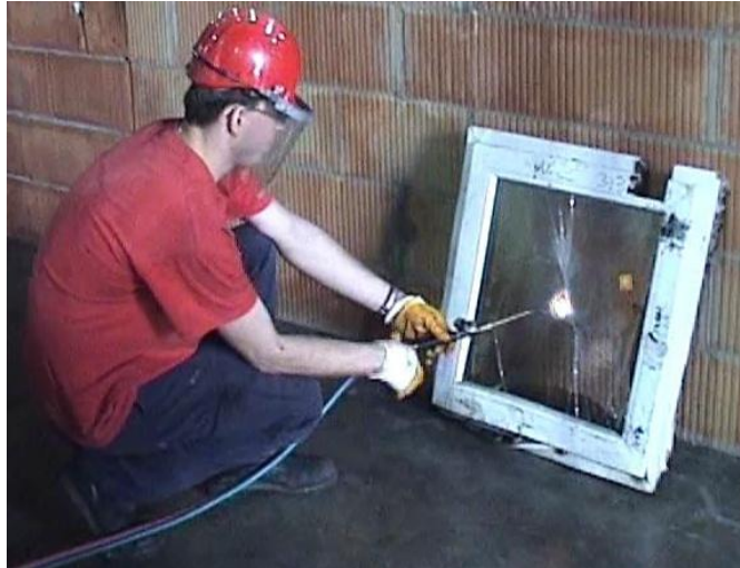
Abbildung 8-3: Rissbildung nach Wegnahme der Schneidbrennerflamme
