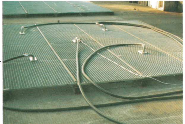
Bild 15b. Gitterauflage und Schlauchleitungen für 5 Sprinkler.
