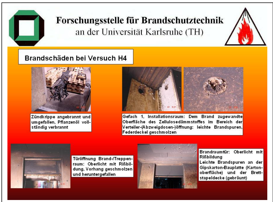
Bild 18: Brandschäden bei absichtlich verzögerter Auslösung der Niederdruck-Wasserebellöschanlage
