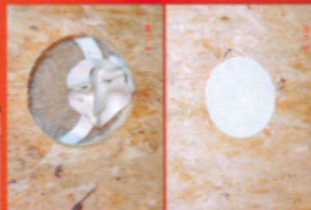
Öffnungen und Federdeckel des Installationsraumes von Gefach 1: unten, Mitte, oben
