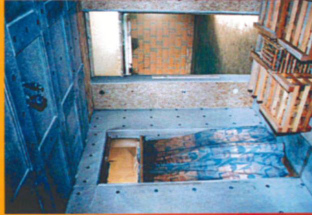
Oberlicht über der Türöffnung Treppenraum > Brandraum sowie über der Tür Versuchshalle > Brandraum: keine Beschädigung, Vorhang nicht angebrannt
