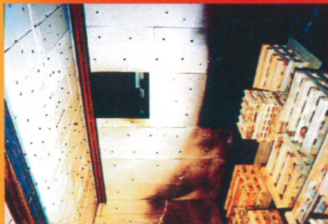
Brandraum mit Stahlträger 1, 2 und Fensteröffnung
